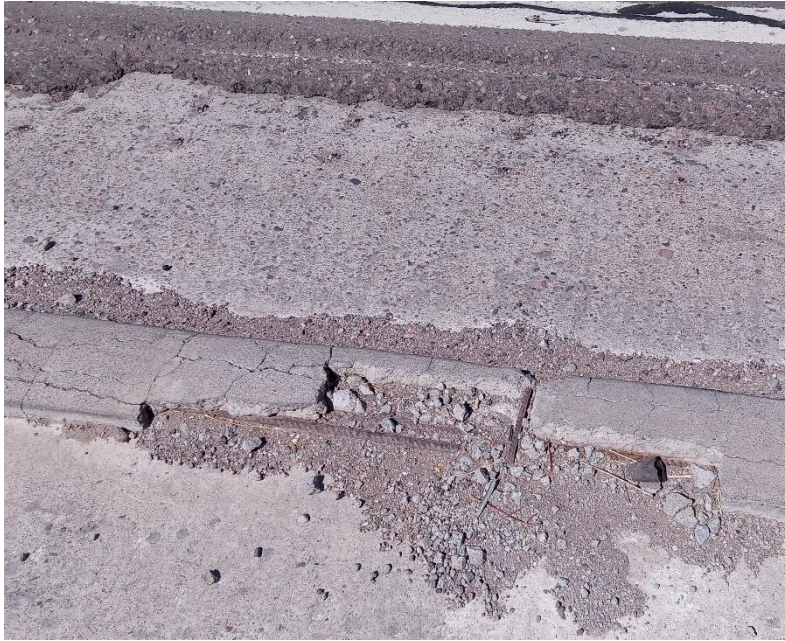
Ilustración 34 situación actual del pavimento RN 143-Garita de colectivos.
