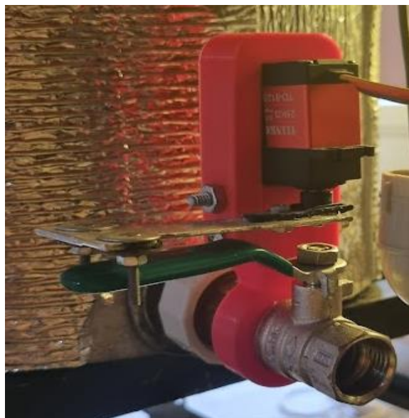
Figura 14: Sistemas de válvula de agua
