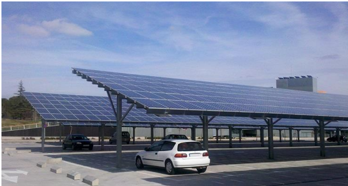
FIGURA N°30 : Paneles solares integrados.
