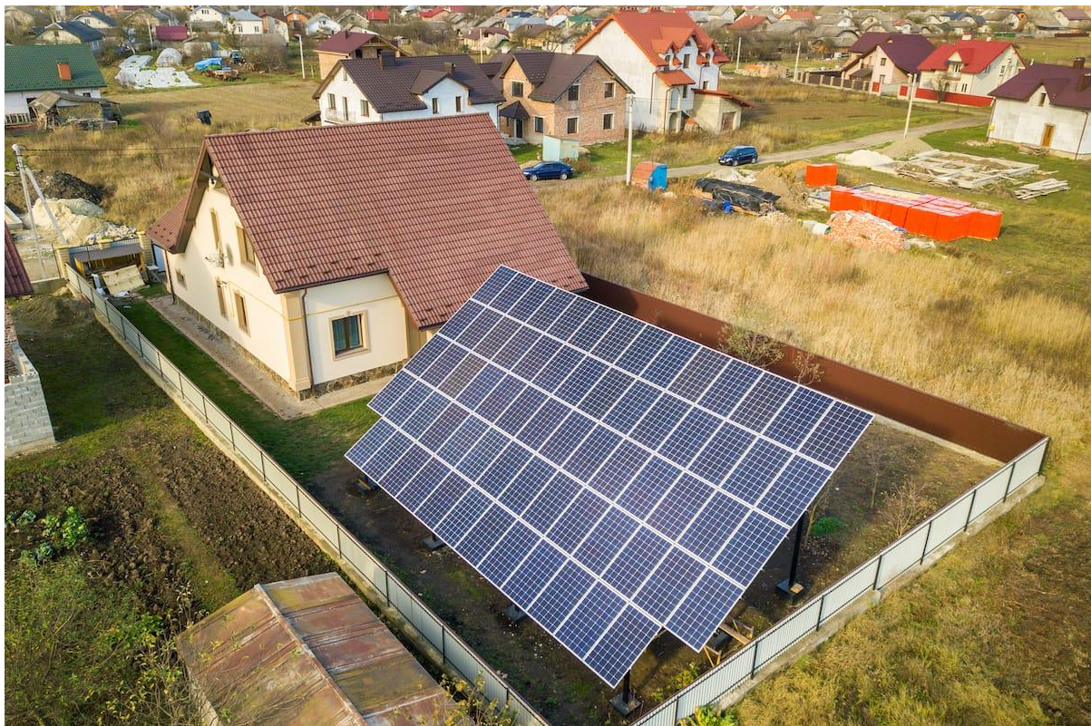
FIGURA N°28: Paneles solares no integrados.
