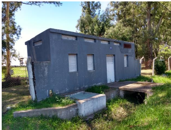
Figura 1-26 – Sala de maniobra de ECOGAS
