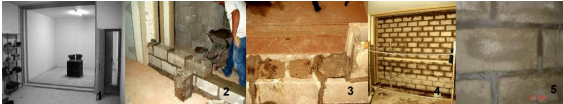
Figura 16. Laboratorio de Sonido. UTN. Reg. Mendoza. Construcción muro acústico. Fuente (Gelardi , y otros)
