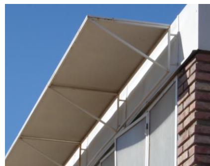
Figura 29. Aplicación alero. Escuela N°4-041 A. Moreau de Justo en Lavalle. Fuente: (Pattini, 2007)
