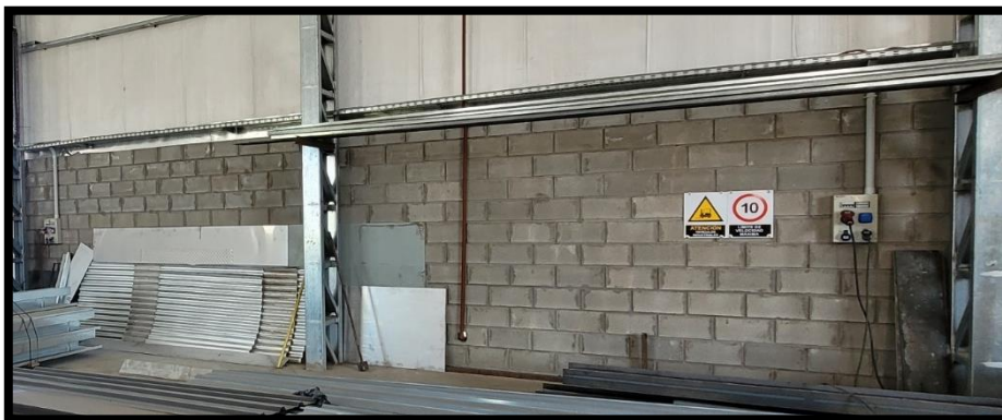
Figura N°50: Instalación eléctrica sobre parte oeste del taller.
