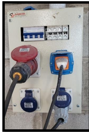
Figura N°52: Detalle de uno de los tableros secundarios.
