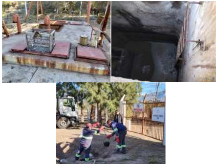
Figura N°4. Estación de Bombeo
