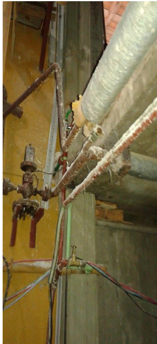
Figura 10: cañería en mal estado.
