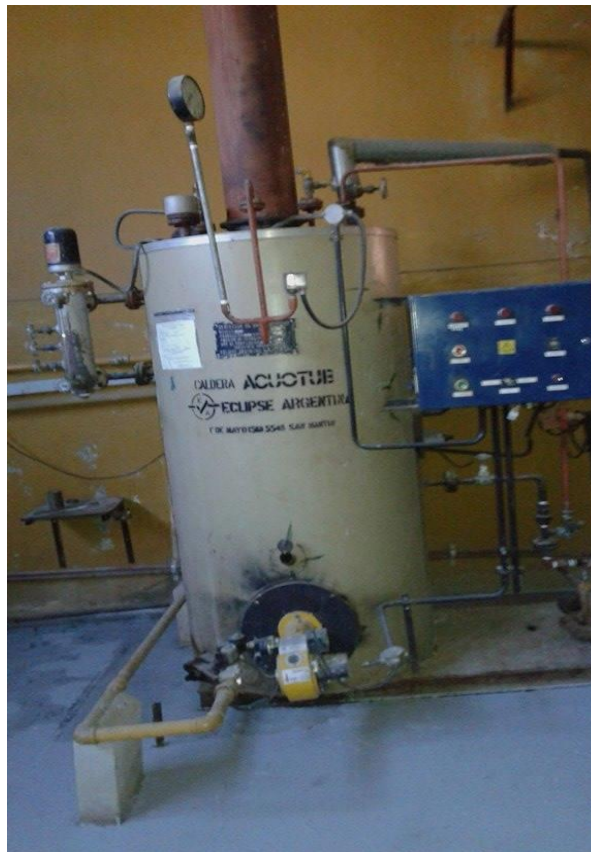
Figura 6: Vista frontal de la caldera.
