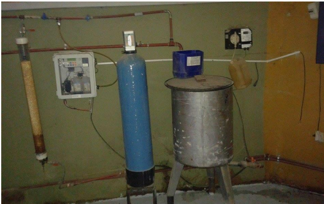
Figura 7: Equipo encargado del tratamiento del agua de la caldera.
