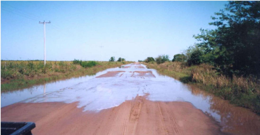
Figura 62 – Ilustra la falta de alcantarillas y altura del terraplén.
