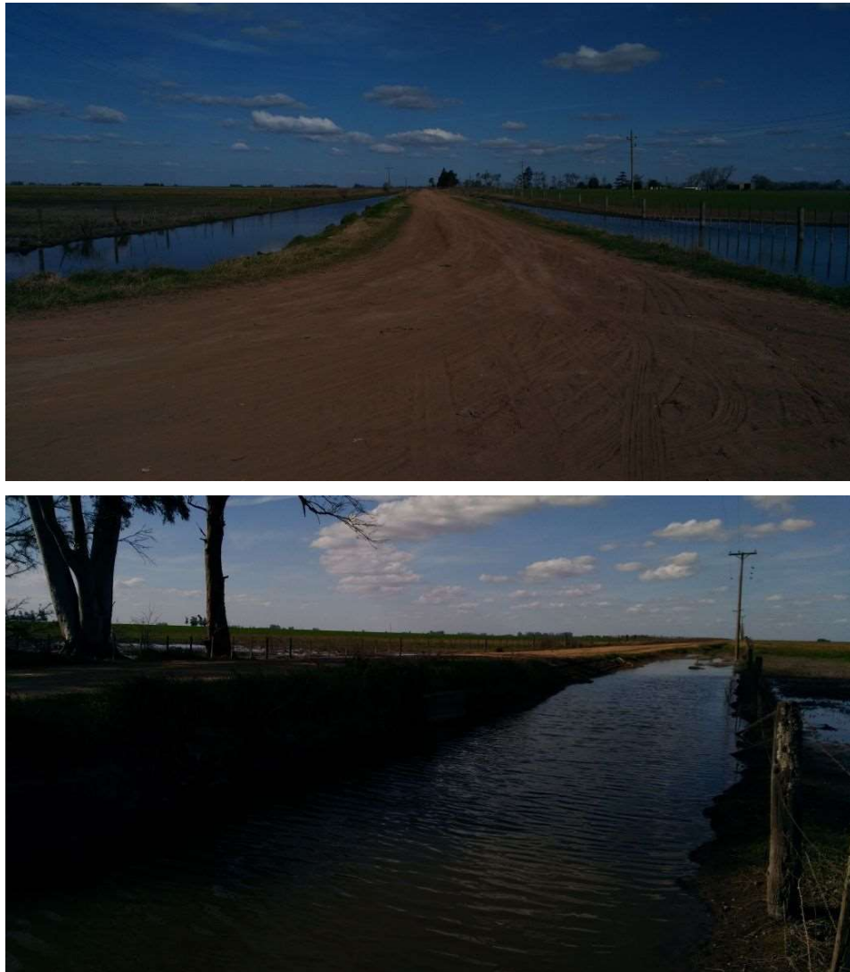
Figura 43 – Estado actual Tramo III del Camino CM01-Z4
