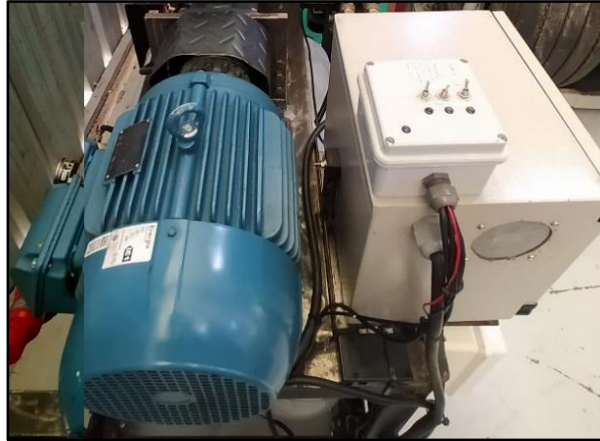
Figura 4: Conexiones externas entre gabinetes y actuadores. Fuente: Fotografía tomada en la empresa.
