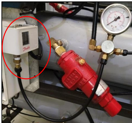
Figura 5: Conexión externa del presostato. Fuente: Fotografía tomada en la empresa.
