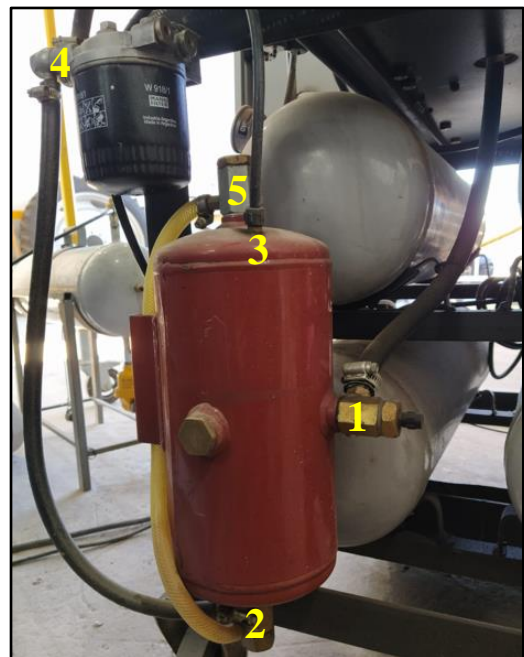
Figura 51: Depósito de aceite del sistema de lubricación. Fuente: Fotografía tomada en la empresa.
