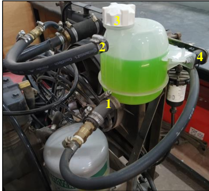
Figura 55: Depósito de líquido refrigerante. Fuente: Fotografía tomada en la empresa.
