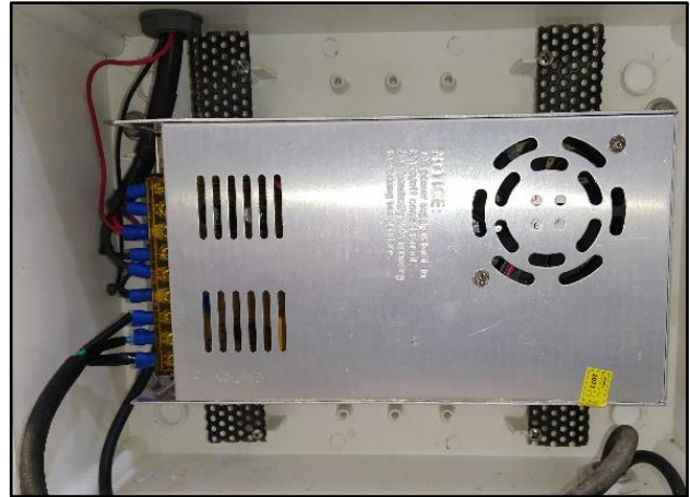
Figura 7: Interior gabinete secundario. Fuente: Fotografía tomada en la empresa.
