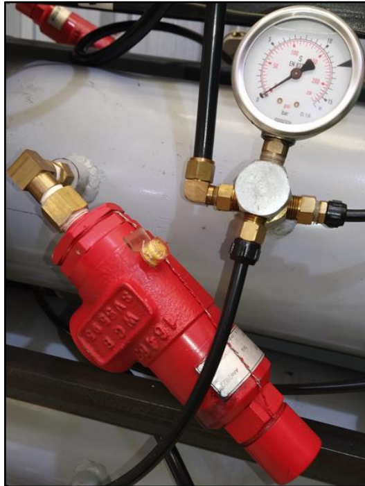
Figura 40: Válvula de seguridad AERRE 1700 colocada en el depósito ASP17-24-015. Fuente: Fotografía tomada en la empresa.
