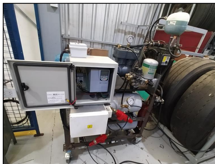
Figura 69: Unidad de Ensayo finalizada, funcionando en ex Sala de Pruebas de Ingeniería, en Planta N°1 COL-VEN S.A. Fuente: Fotografía tomada en la empresa.
