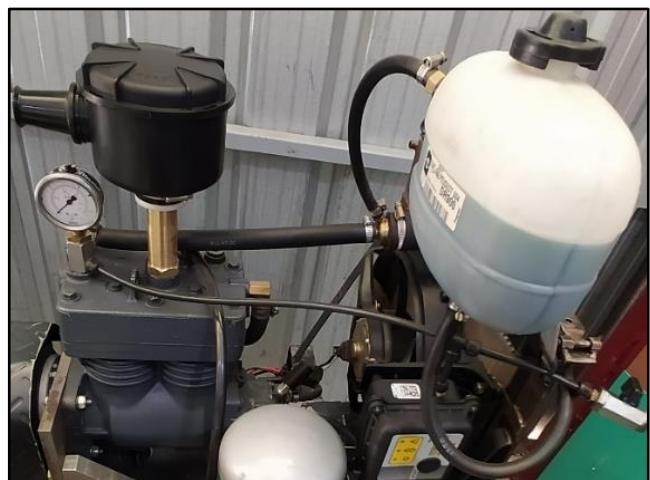
Figura 14: Conexiones entre depósito, radiador, y salida del circuito de refrigeración del cabezal. Fuente: Fotografía tomada en la empresa.
