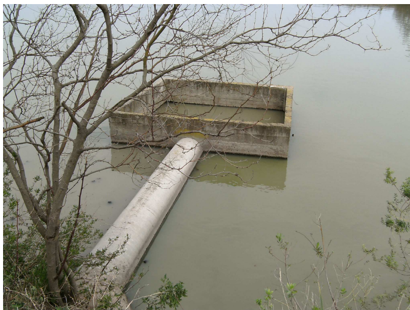
Foto 4: Falta de mantenimiento en las lagunas.
