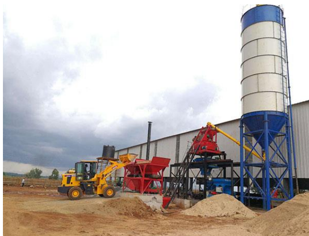
Figura 43, planta de hormigón.
