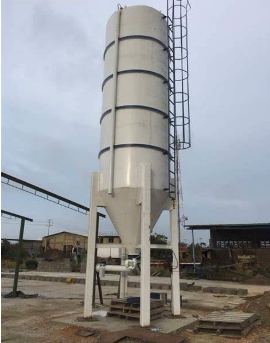
Figura 31, Tolva acopiadora de cemento.
