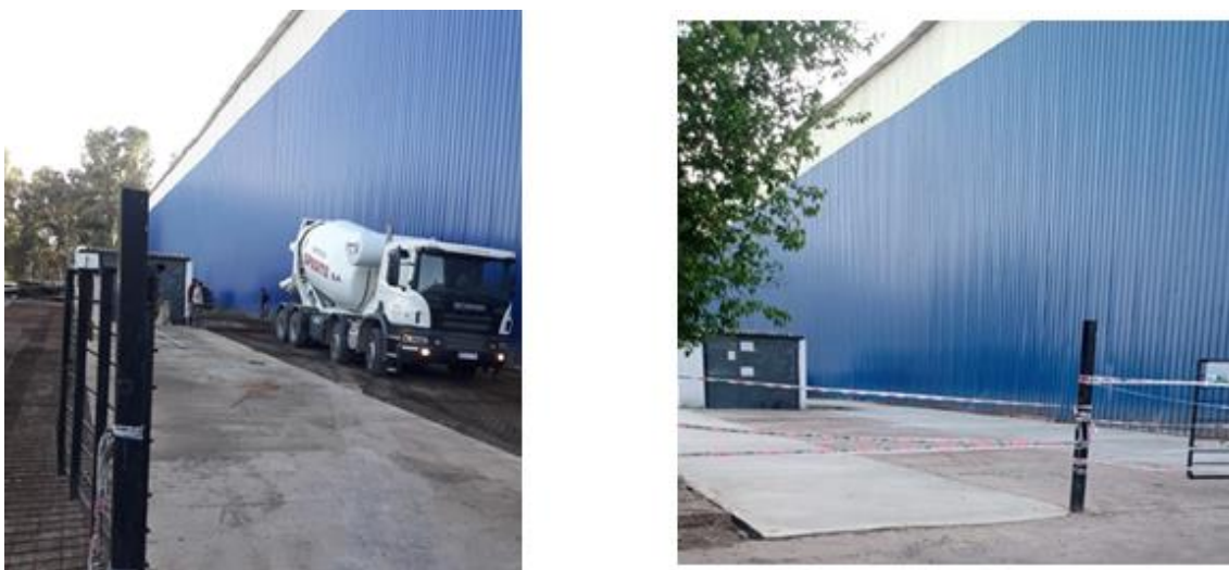
Figura 5: depósito transitorio de residuos en construcción.
