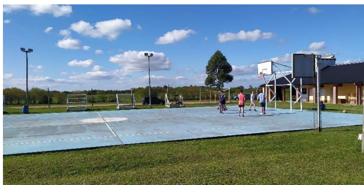
Figura 3.7 – Estado actual de la pintura de la cancha de básquetbol.
