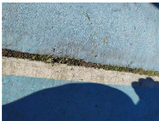
Figura 3.6 – Estado actual de las juntas de paños de losa.
