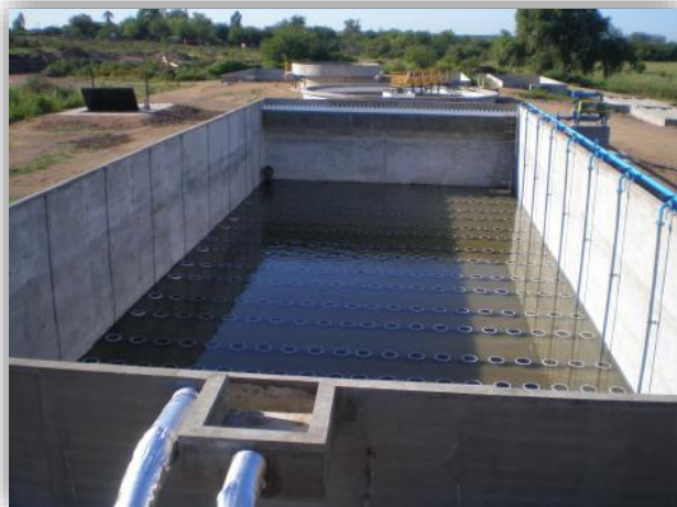
Ilustración 106: Tanque de aireación
