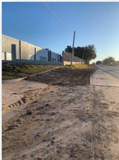
Ilustración 50- Banquina en mal estado
