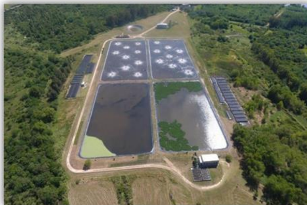
Ilustración 41- Planta de tratamiento Gualeguaychú
