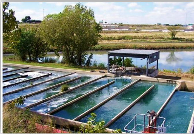
Ilustración 107- Cámara de cloración
