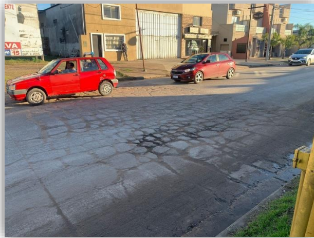
Ilustración 45- Pavimento en mal estado
