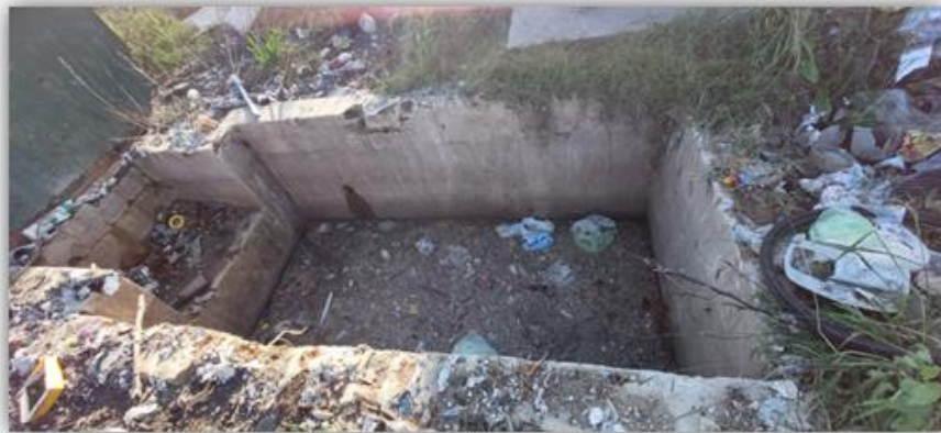
Ilustración 39- Estructura deteriorada planta de tratamiento
