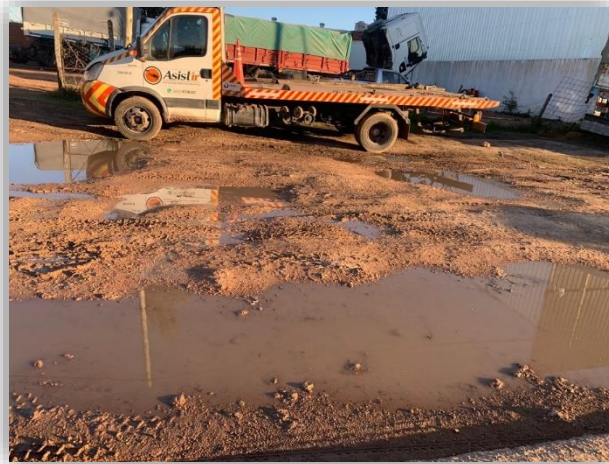
Ilustración 51- Banquina en mal estado
