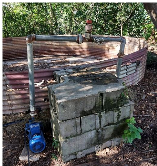
Figura 3: Tanque australiano de 30m 3 de capacidad en desuso y bomba impulsora.
