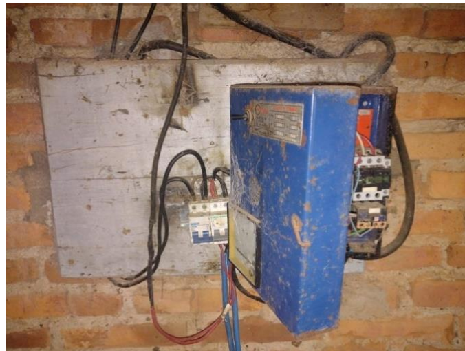
Figura 9: Tablero eléctrico existente dentro del depósito.
