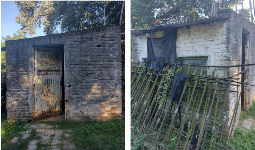
Figura 8: Depósito de tablero eléctrico a refaccionar.
