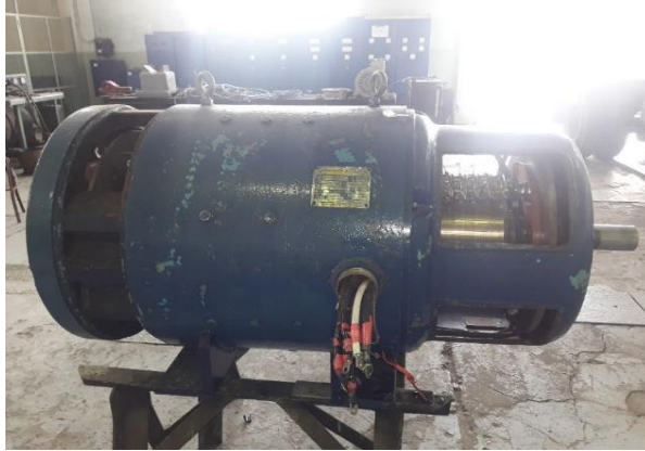
Figura 3. Generador del motor de traslación
