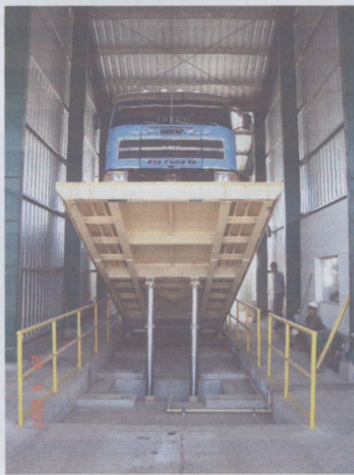
Fig. 22 –Plataforma Volcadora – Camión en plena descarga
