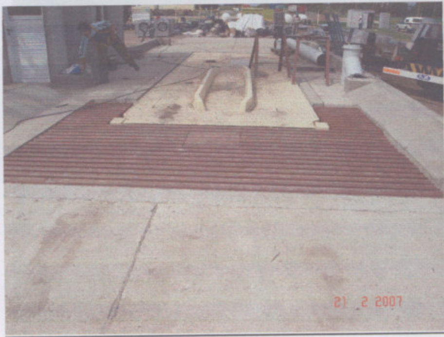
Fig. 34 - Rejilla de Tolva y plataforma volcadora
