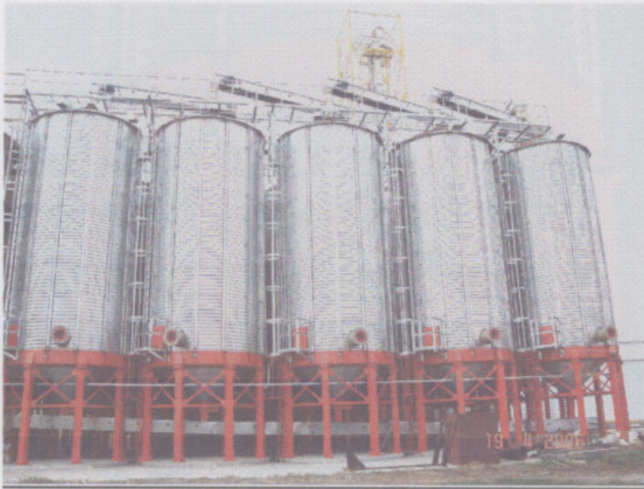
Fig. 12-1 –Silos de Húmedo y Tempering-Vista general
