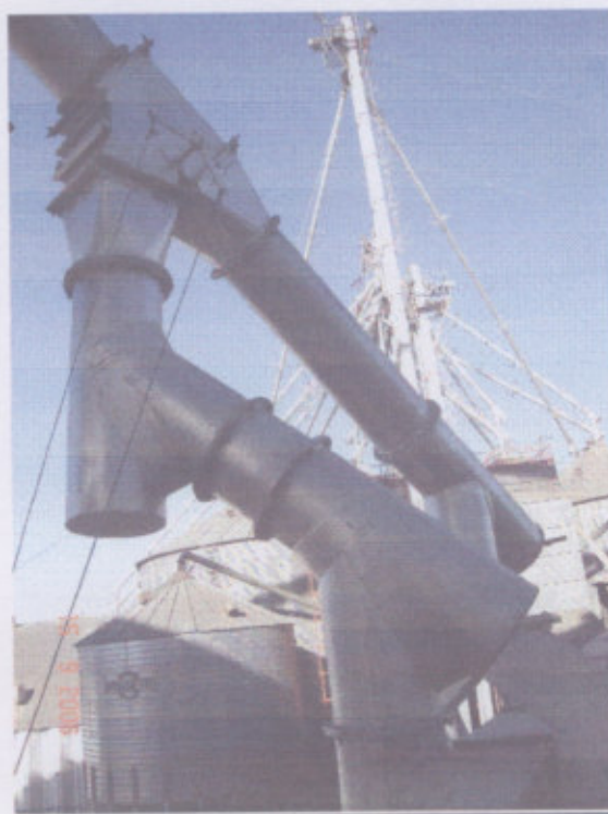
Fig.95- Cañería - Válvula, amortiguadores, bridas
