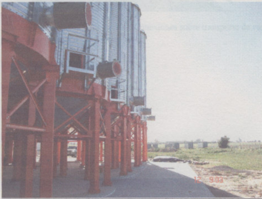
Fig. 15 –Silos de Húmedo y Tempering-Ubicación de Ventiladores
