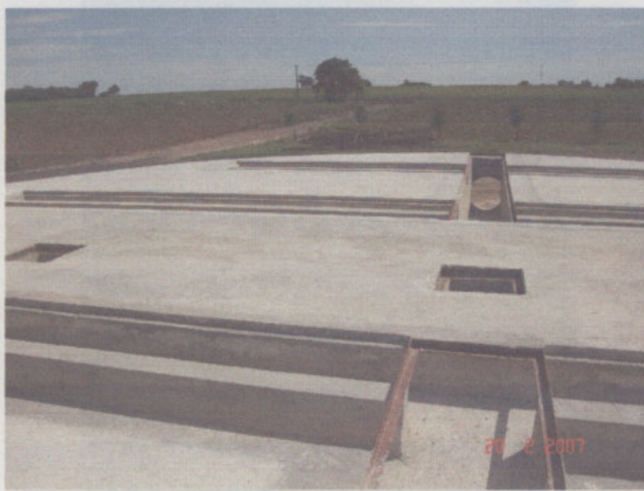
Fig. 4 – Obra civil de silo fondo plano-Bocas de vaciado y canales de aireación
