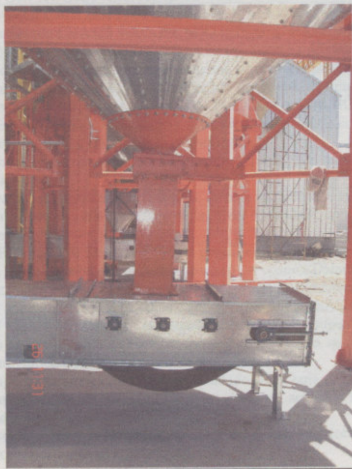
Fig. 16 –Silos de Húmedo y Tempering-Conexiones sobre transporte de vaciado
