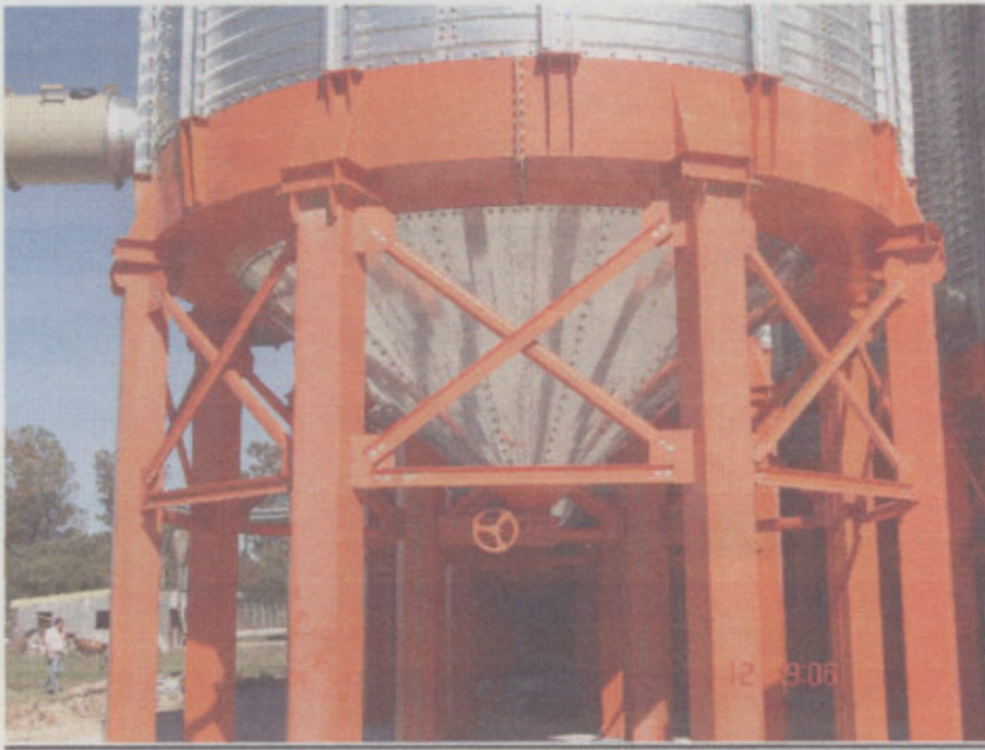
Fig. 14 –Silo de Húmedo y Tempering-Vista parte inferior
