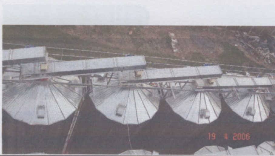
Fig. 13 –Silos de Húmedo y Tempering-Transporte de llenado
