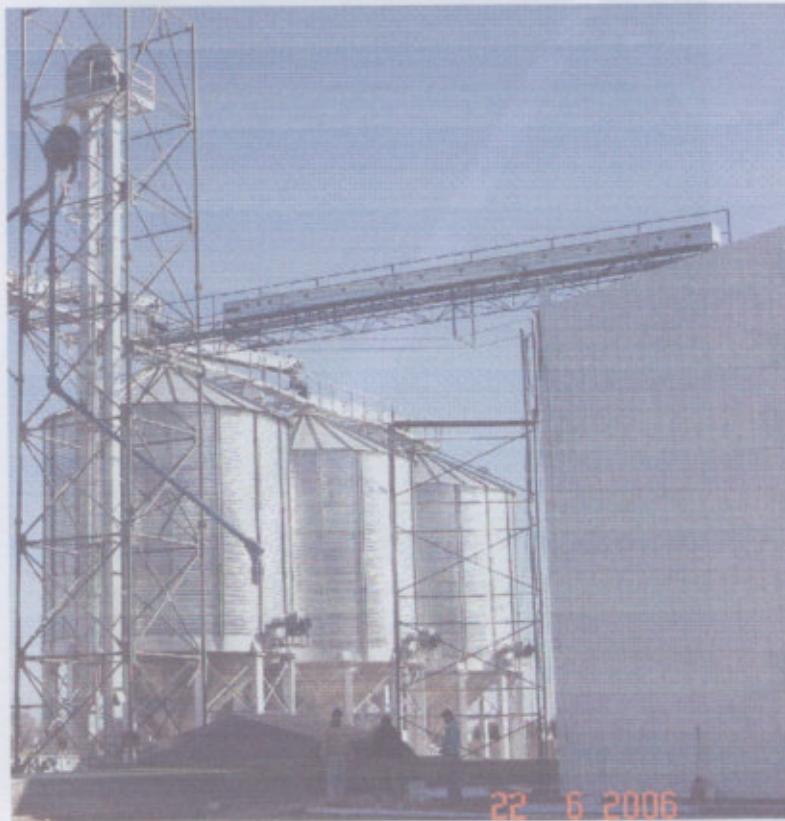
Fig.75- Pasarelas de servicio para transportes aéreos
