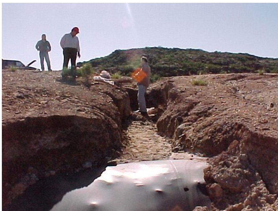
Erosión en la Cubierta de la Pila:
