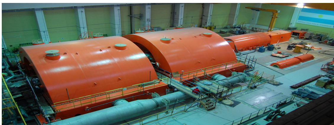
Figura 11. Conjunto turbina de vapor-alternador de la CNA II.
