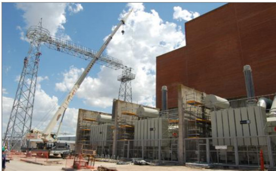
Figura 43. Banco de transformadores monofásicos. CNA II.
