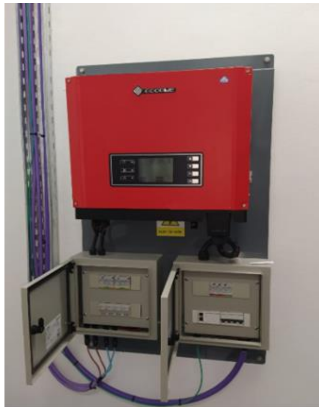
Ilustración 19. Inversor con tableros de protecciones
