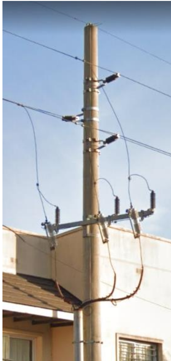
Ilustración 29. Protecciones para bajada subterránea
