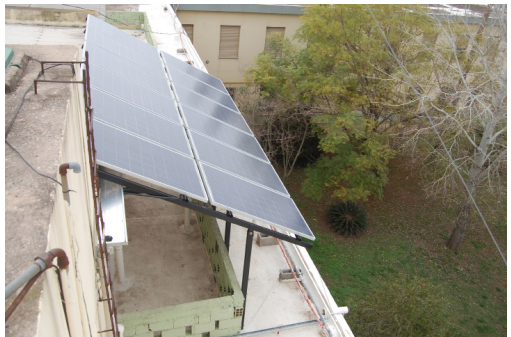
Instalación Piloto de Paneles Fotovoltaicos.
