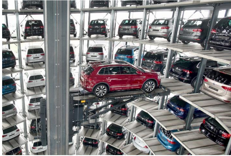
Figura 3.3: Sistema de estacionamiento robotizado.
