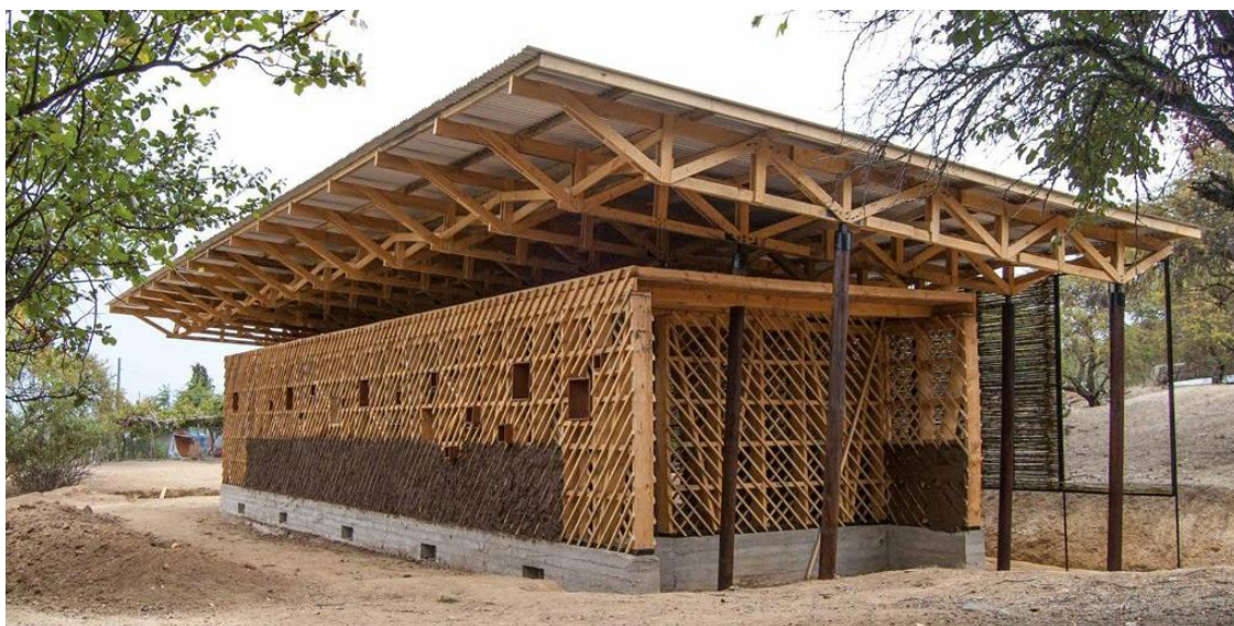
Figura 3: Embarrado del entramado de una bodega vitivinícola construida con la técnica de quincha en la comuna de Cauquenes, Chile. Fuente: Libro “Architecture en Terre D’Aujourd [15].
