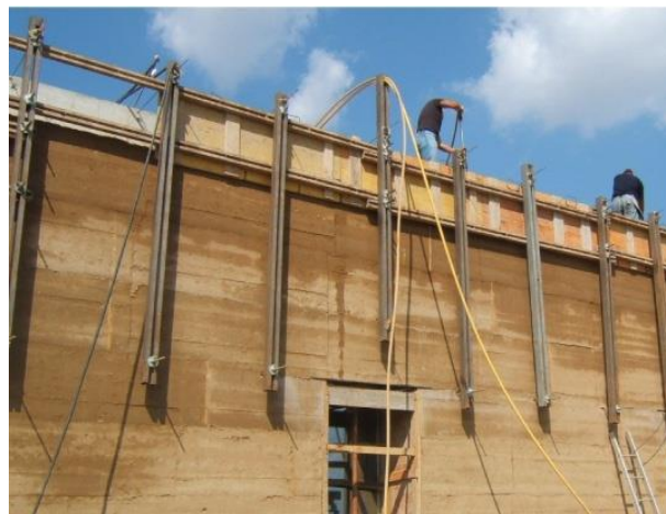
Figura 6: Construcción de un muro de tapia con encofrados trepantes y pisones neumáticos. Fuente: Libro “Architecture en Terre D’Aujourd” [15].
