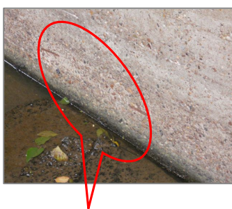
Fig. 6 Exposición de los áridos y armadura corroída, en la parte inferior de las pilas, por lixiviación del cemento.
