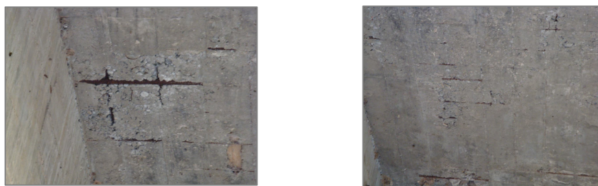
Fig. 10 Vista de la cara inferior del tablero del puente, donde se observan la falta de recubrimiento.
