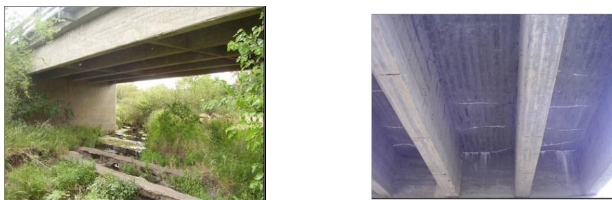
Fig. 5 Vista inferior del puente entre pilas uno y dos (Izq.). Y Vista de fisuras en el tablero superior con procesos visibles de lixiviación. En vigas se observaron hierros afectados por corrosión (der.).
