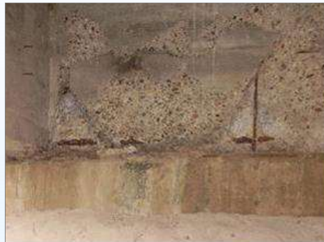
Armadura expuesta y procesos corrosivos
