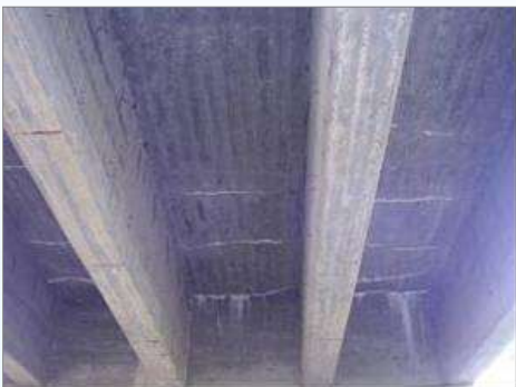
Fisura del tablero con proceso de lixiviación
