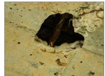
Problemas constructivos: falta de recubrimiento y oquedades
