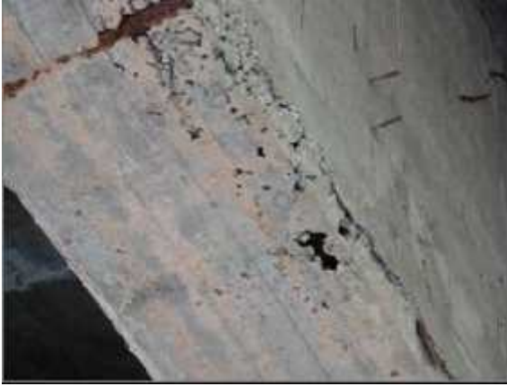
Figura 4. Falta de recubrimiento - hierros separadores expuestos
