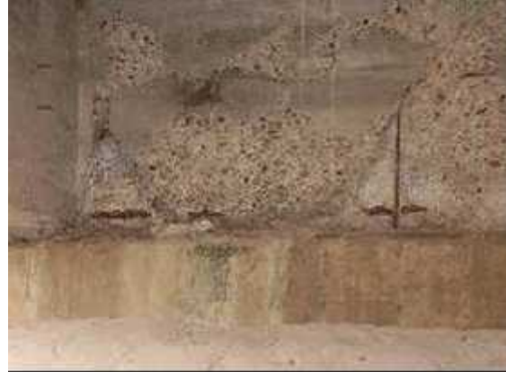
Figura 3. Armadura expuesta y procesos corrosivos
