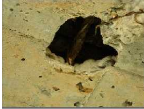
Figura 5. Oquedades que dejan hierros expuestos
