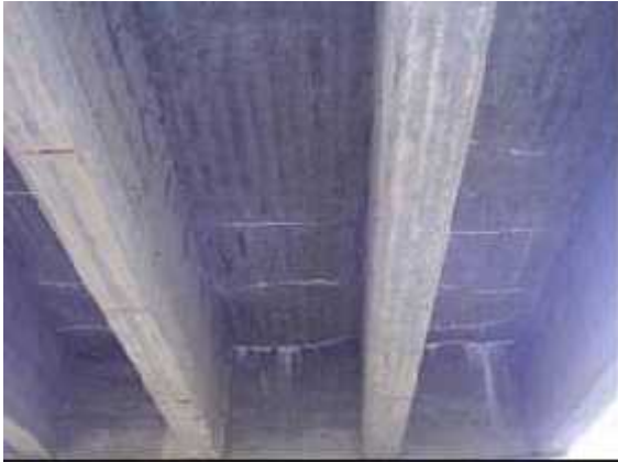
Figura 2. Fisuras del tablero superior con proceso de lixiviación
