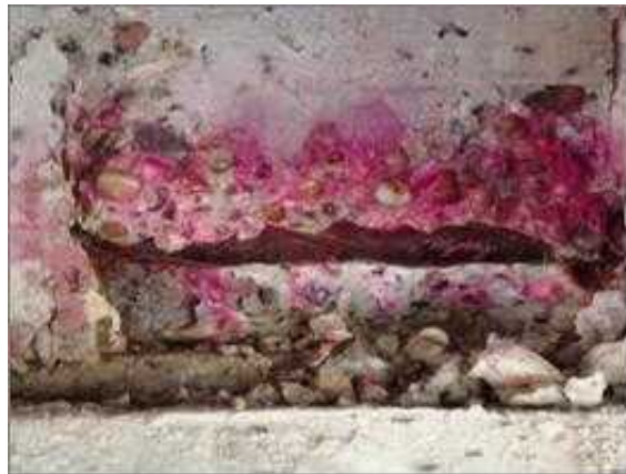
Figura 6. Ensayo de carbonatación sobre viga principal
