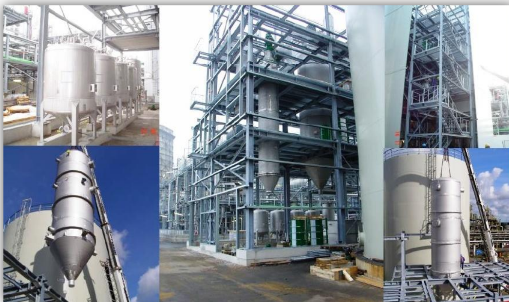
Fig. 82: Imágenes de la estructura de proceso.
