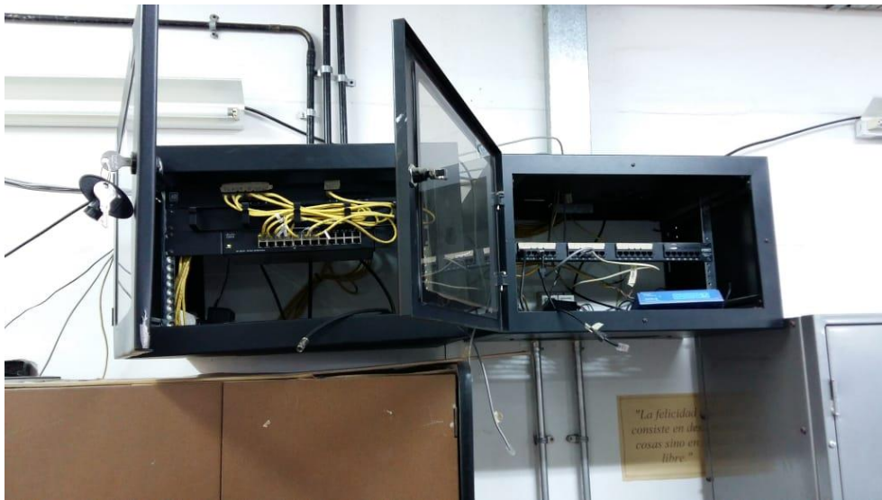
Racks de distribución pertinentes al servidor Ubuntu
