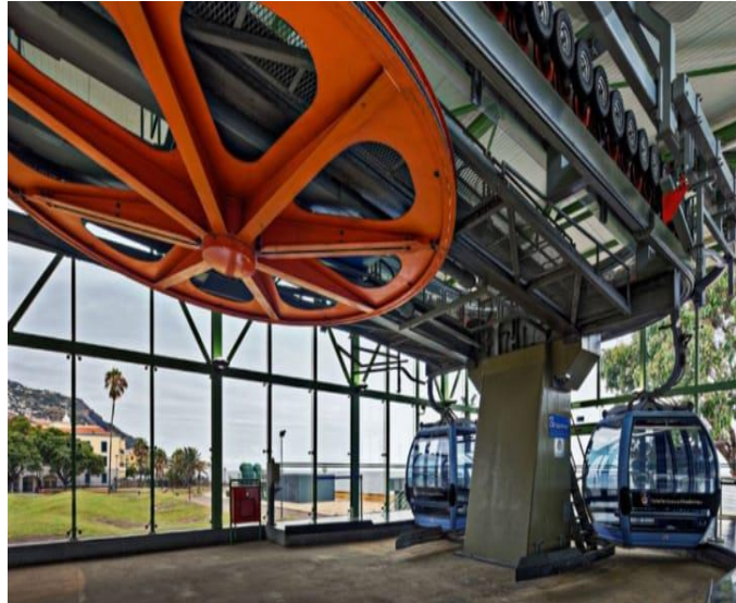
Figura 3.13 Sistema de tensado de cable tractor
