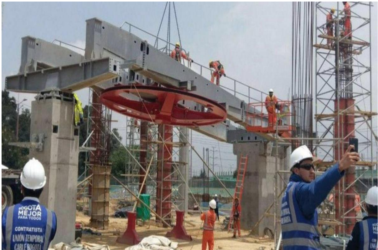
. Figura 4.4 Estación de salida- Mi teleférico La Paz- Bolivia.
