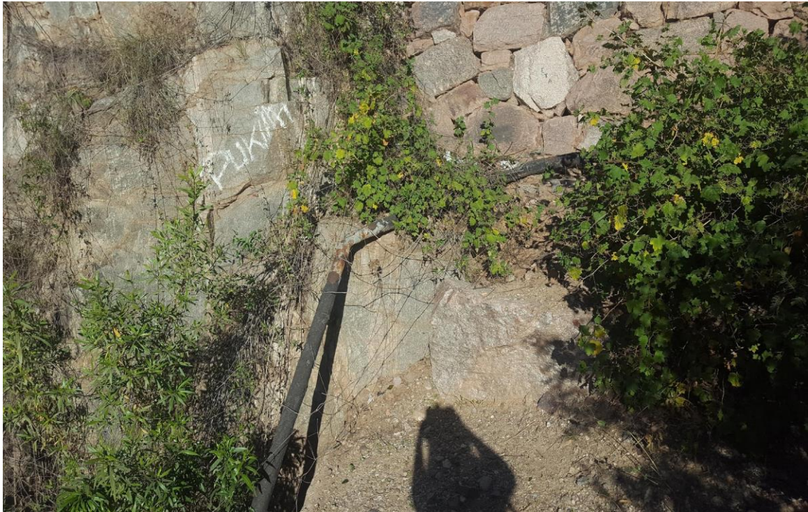
Figura 5.12 Cañería Ø75mm de hierro fundido – fuera de servicio
