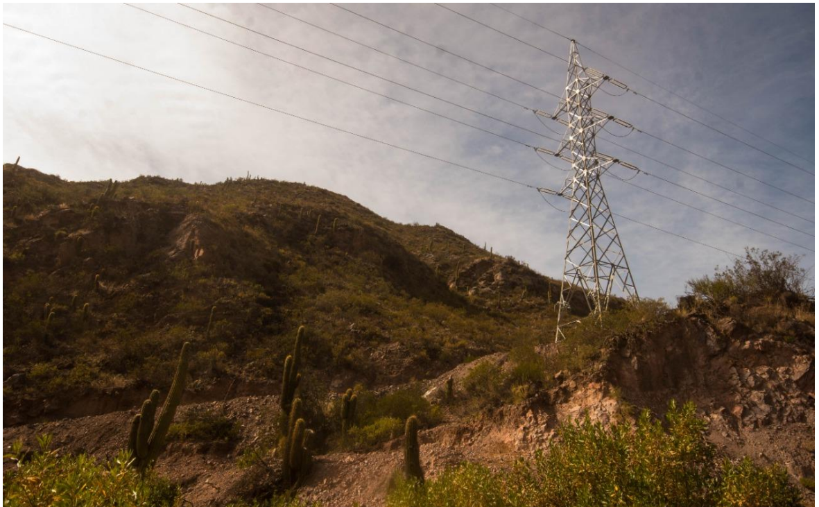
Figura 5.19 línea de alta tensión - La Rioja – Chilecito
