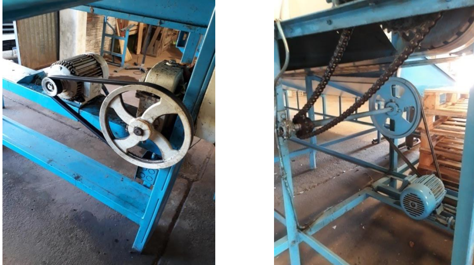
Figura 5.1.1. Falta de protección mecánica en partes móviles
