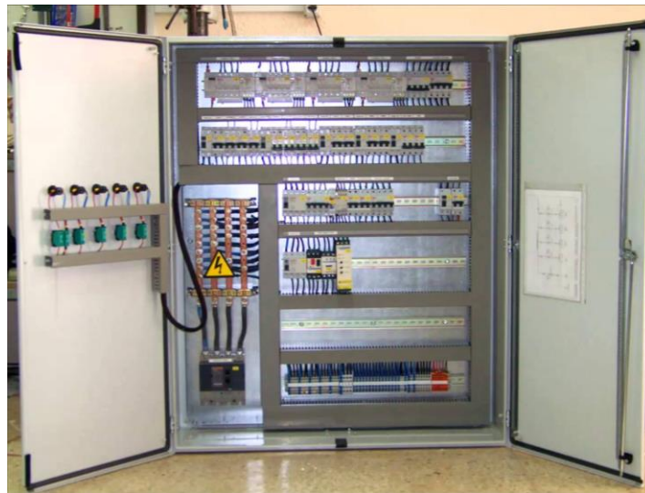
Figura 12.1: Tablero eléctrico. Fuente: (ConstruArte, 2021).
