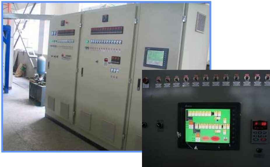
Imagen 29 – Gabinetes de control
