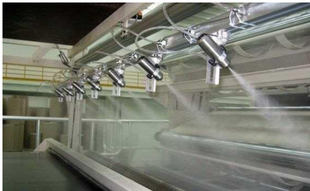
Imagen 37 – Sistema de control contra incendios
