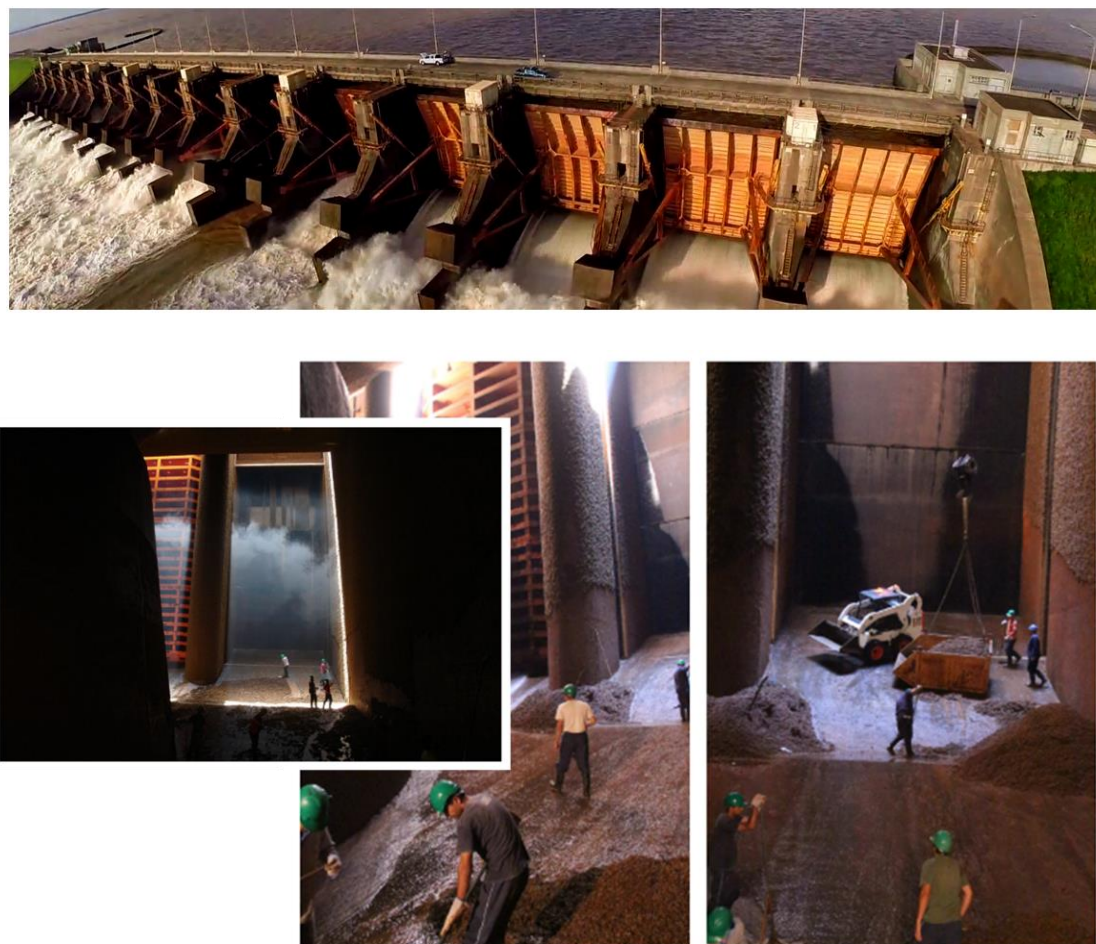
Figura 1.3. Represa del Ente Binacional Yacyretá. Se observan las paredes de hormigón de las cámaras espiral de las unidades generadoras, totalmente colonizadas con incrustaciones de mejillón dorado. La limpieza de la cámara espiral se realiza mecánicamente, desprendiendo los mejillones de las paredes y volcándolos en contenedores para su disposición. Fuente: https://www.eby.org.ar/limpiezacamaraespiral
