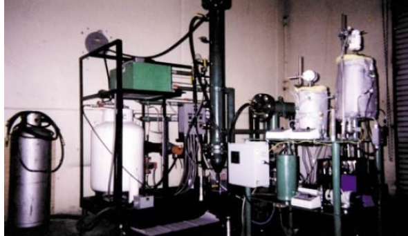
Fig. 3-6. Planta piloto Pre-tratamiento y extracción con propano
