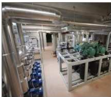
Centrali Frigorifere settoie alimentare
