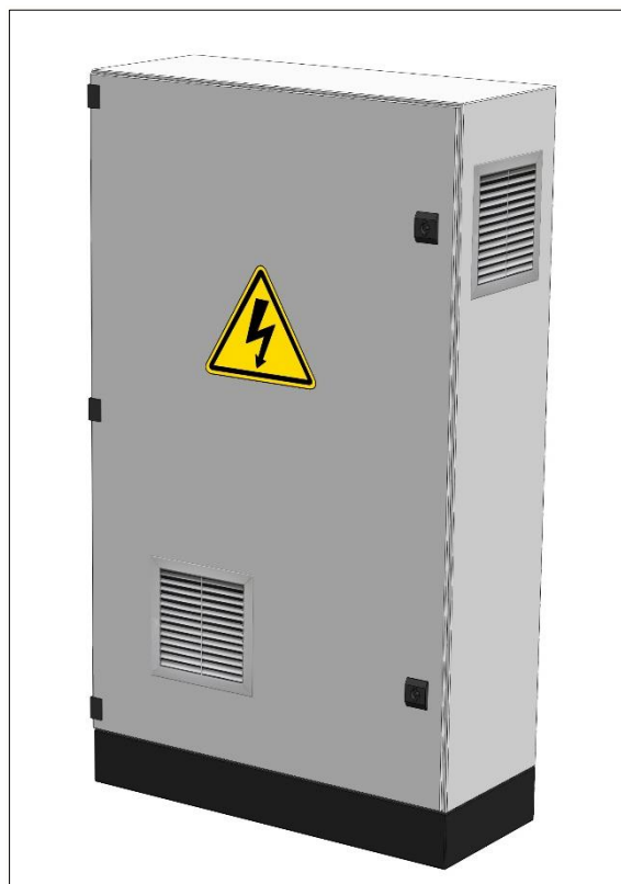
Figura 6.91: Gabinete de potencia.
