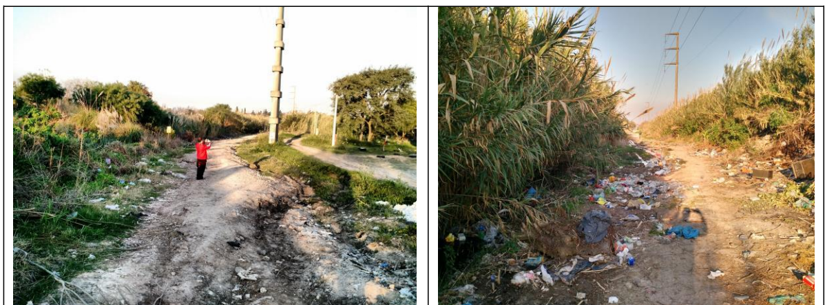
Fotos 3 y 4. Condiciones del camino en el tramo. Prog. 100 y prog. 150
