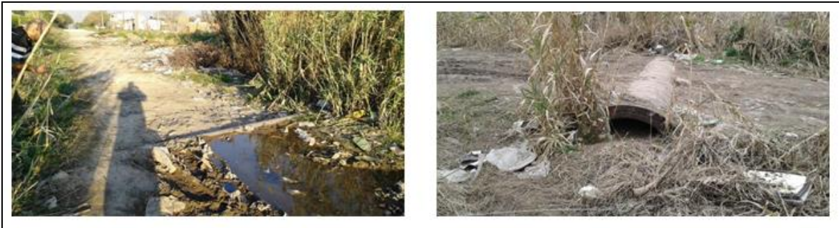
Primer alcantarilla transversal, ubicada en progresiva 384, reemplazará a una de caño de chapa, sin cabezal, de sección insuficiente ( \varnothing = 0,60m ) y embancada, es decir obstruida con barro y malezas.
