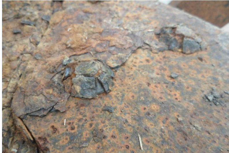
Figura 13: Roblones y Planchuela corroídos.
