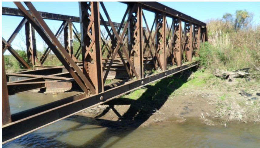
Figura 12: Ausencia de estribo norte.
