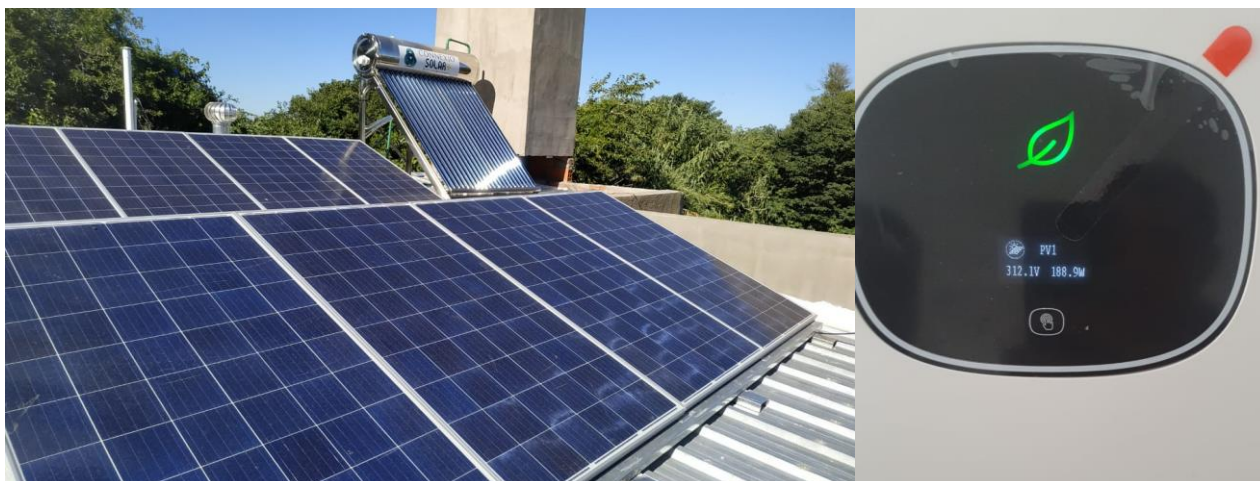
Figura 52. Equipo solar fotovoltaico instalado en el prototipo de VES en Paraná.
