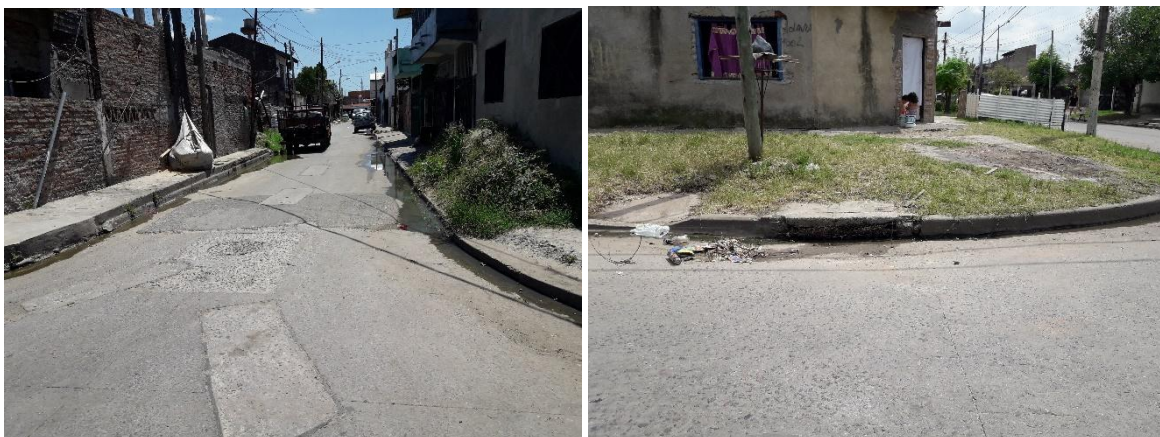
Figura 37: Pavimentos y redes de desagües pluviales urbanos. Fuente: elaboración propia mediante relevamiento territorial.
