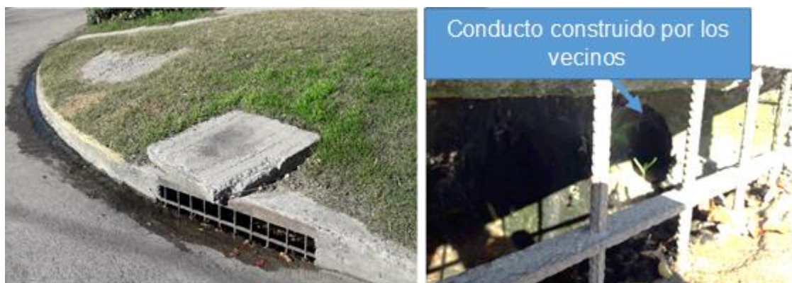
Figura 68: Conducto construido en el asentamiento SJO por los vecinos donde se vuelcan líquidos domésticos a la red de pluviales. Fuente: Elaboración propia a partir de relevamiento de campo.
