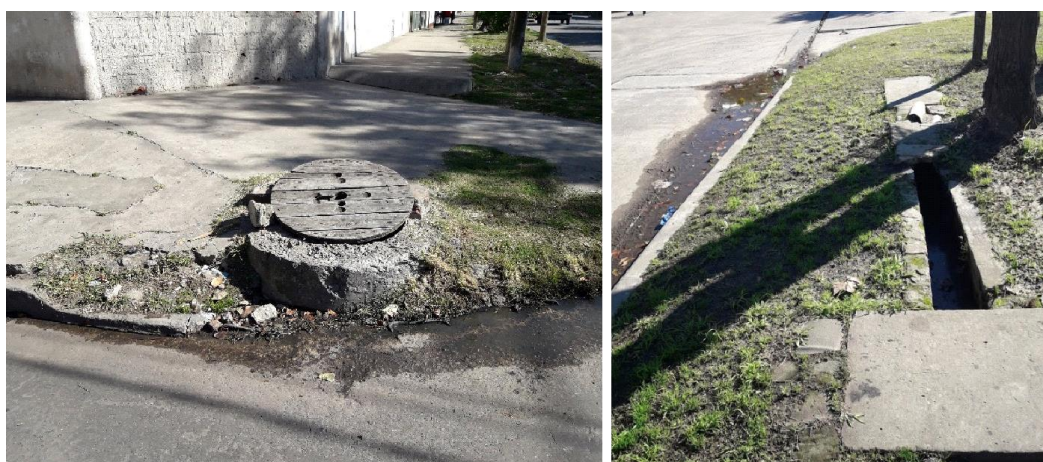
Figura 69: Cámaras de inspección y canal autoconstruido por los vecinos sobre las veredas públicas en el asentamiento SJO. Fuente: Elaboración propia a partir de relevamiento de campo.
