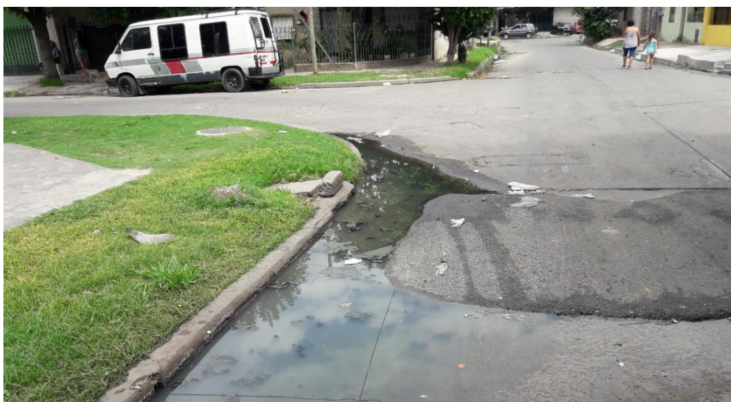
Figura 44: Imágenes fotográficas tomadas en el área de estudio durante el relevamiento de campo. Se observa líquido sobre la vía pública en tiempo seco. Fuente: Elaboración propia.
