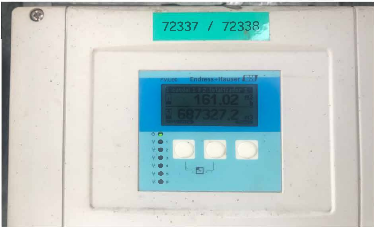
MEDIDOR DE CAUDAL DE INGRESO A PLANTA EN 161.02 M3/H
