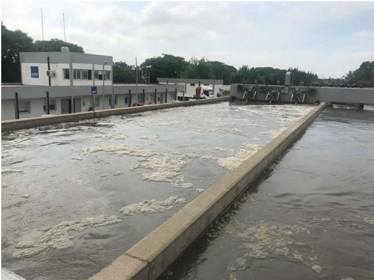
VISTA DE REACTORBIOLÓGICO EN FUNCIONAMIENTO
