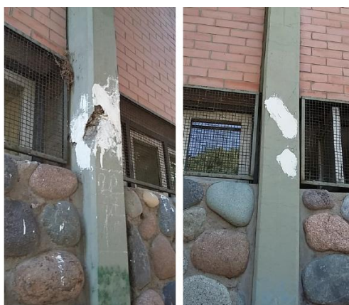
Fig. 1. Patología de Columna Corta. Escuela Pío XII. Ciudad de Mendoza, Argentina.
