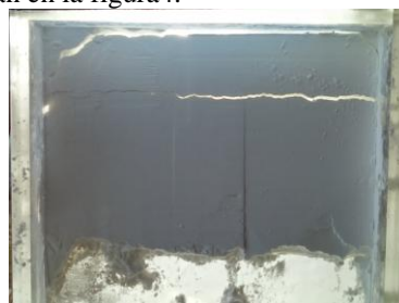
Fig. 4. Rotura y progreso con falla progresiva presente en el material granular. Falla Horizontal.
