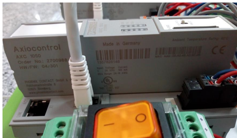
Figura 2 PLC Axioccontrol AXC 1050
