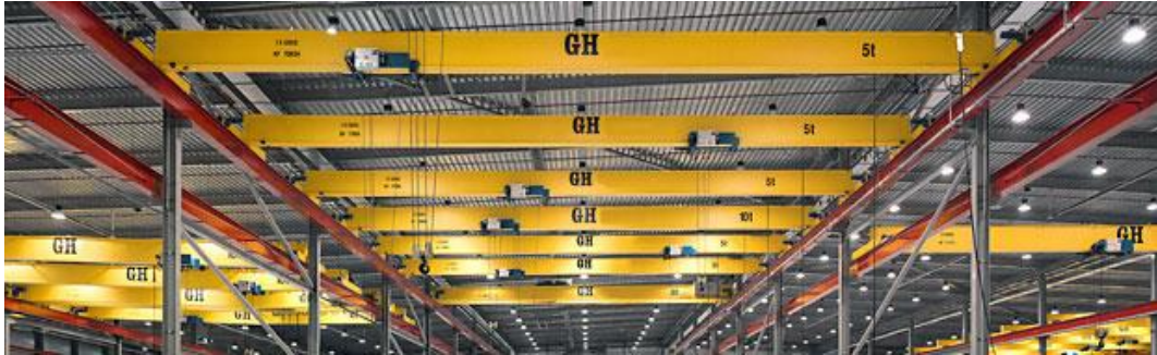
Figura 2.3.2: Grúa Puente Monorriel
