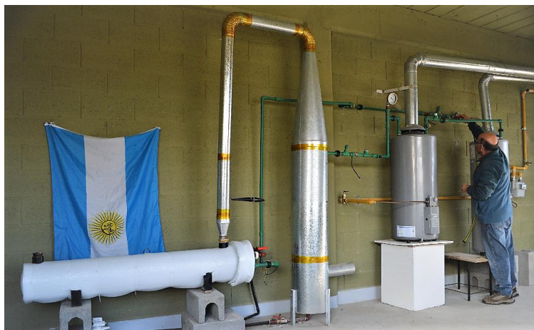
Figura 2. Torre de humidificación y condensador del equipo montado en la Planta Experimental de Hidrógeno de Pico Truncado.
