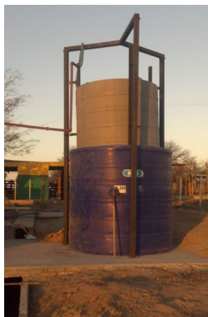
Figura 4. Sistema de acumulación de biogas. Gasómetro
