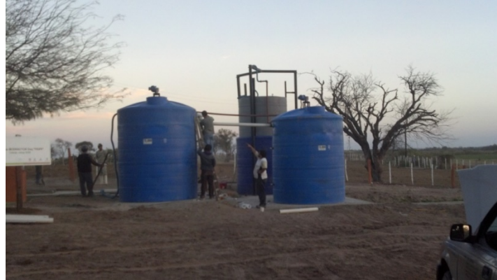
Figura 5. Vista general del sistema terminado
