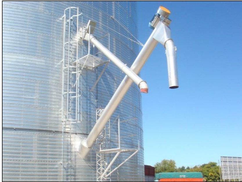
Fig. 5.13: Rosca extractora instalada en silo de almacenamiento.
