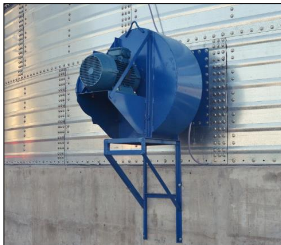
Fig. 5.12: Extractor centrífugo de aire instalado en silo de almacenamiento.
