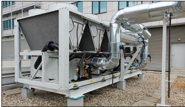
Fig. 6.3: Chiller industrial para el enfriamiento de agua.
