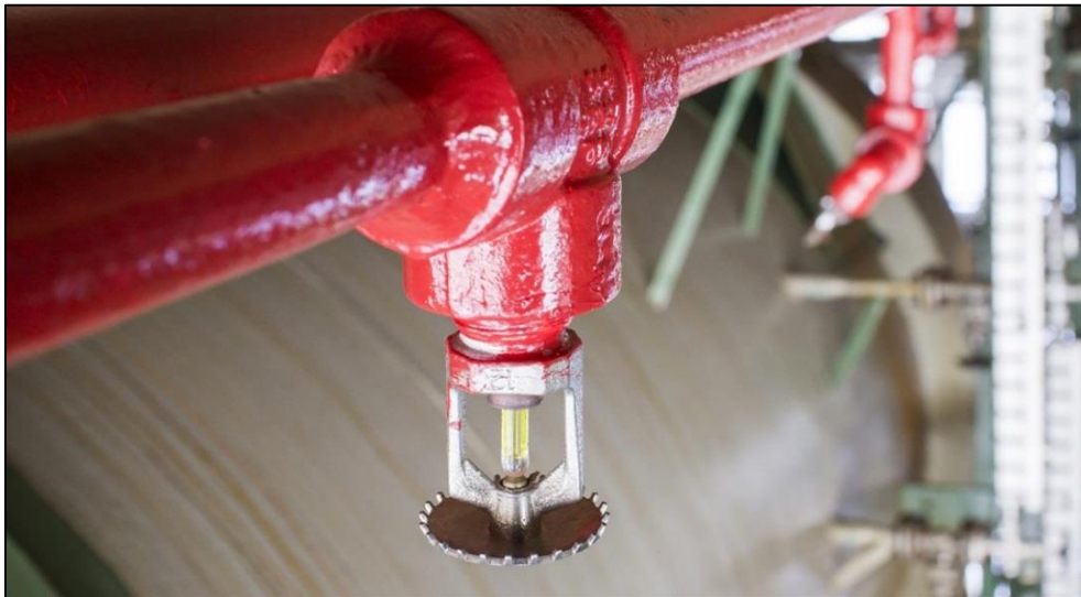
Fig. 12.13: Rociador colgante sobre cañería de servicio.
