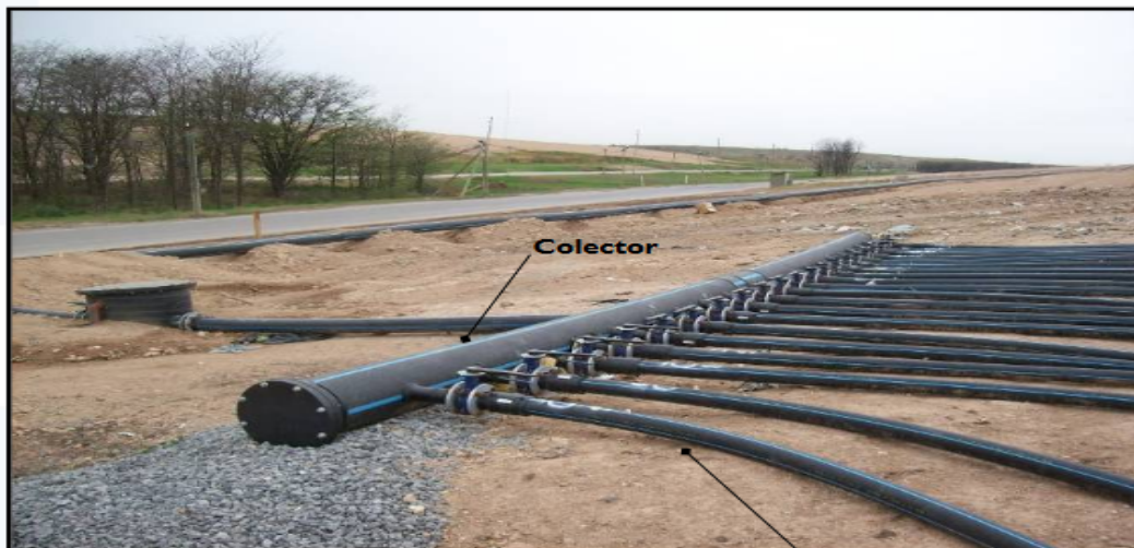
Tuberías laterales provenientes de los pozos de extracción
