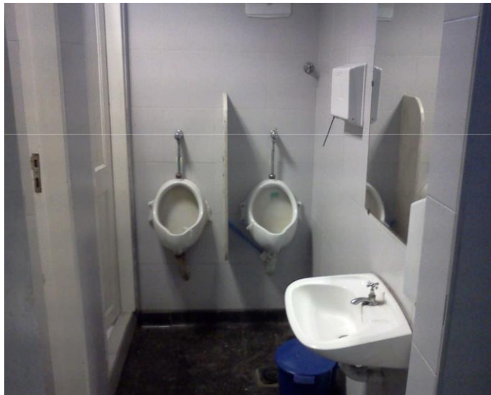
Foto nº 12. Baños de los trabajadores administrativos.
