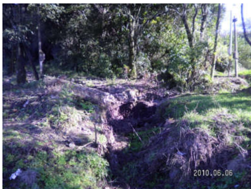
Figura 23: Erosión y desmonte en el límite con la yunga
