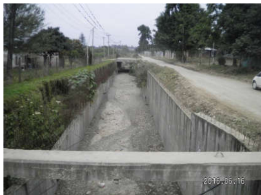
Figura 42: Canal Nueva Esperanza con borde erosionado
