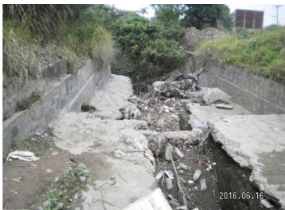
Figura 43: Canal N. Esperanza con destrucciones y proceso erosivo.
