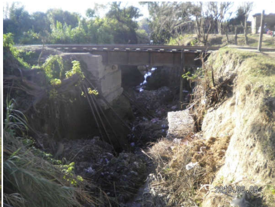
Figura 28: Puente del Ferrocarril Belgrano C/base descalzada sobre A° Quebrada 6
