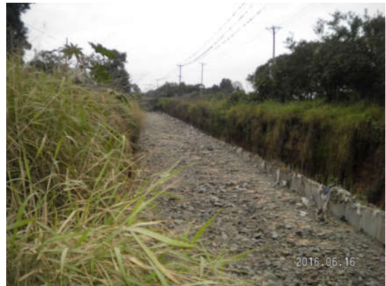
Figura 68: Canal Nueva Esperanza colmatado y muro descalzado. Entre T. 5 y T. 6
