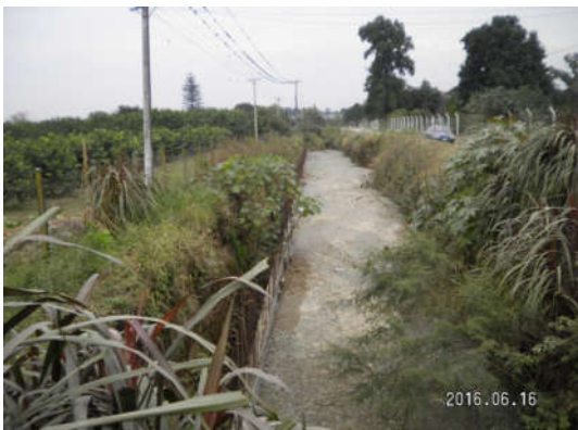
Figura 41: Canal N. Esperanza con una pared descalzada por la erosión y cargado con áridos.
