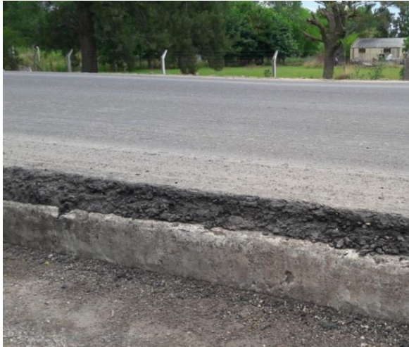
Figura 23. Espesor bituminoso remanente
